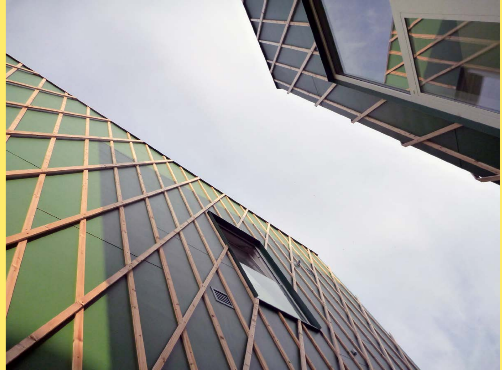
Die Fassaden wurden mit Holzlatten versehen, um eine Begrünung durch Rankpflanzen zu ermöglichen.
